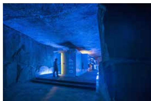
Ci-contre : prototype issu du projet de recherche Deep Data, invention d'un modèle de data center à très faible consommation implanté dans les carrières abandonnées du Saumurois.
